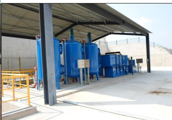
含油污水处理装置
