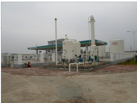
油气回收装置
