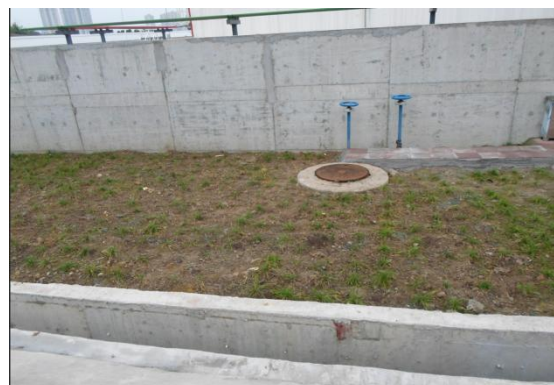
雨污水分流装置及检查井
