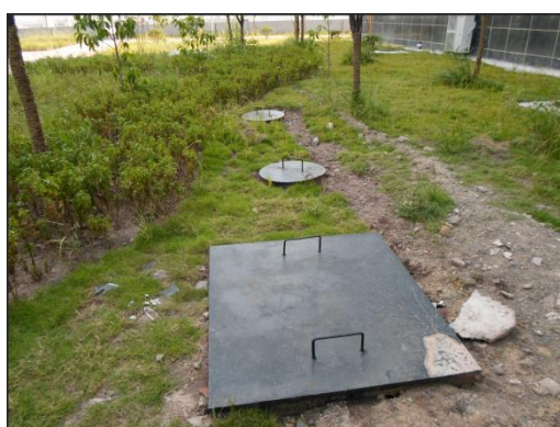
生活污水处理装置
